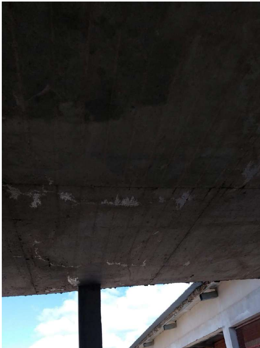
Idem anterior, colocar cerramientos faltantes
